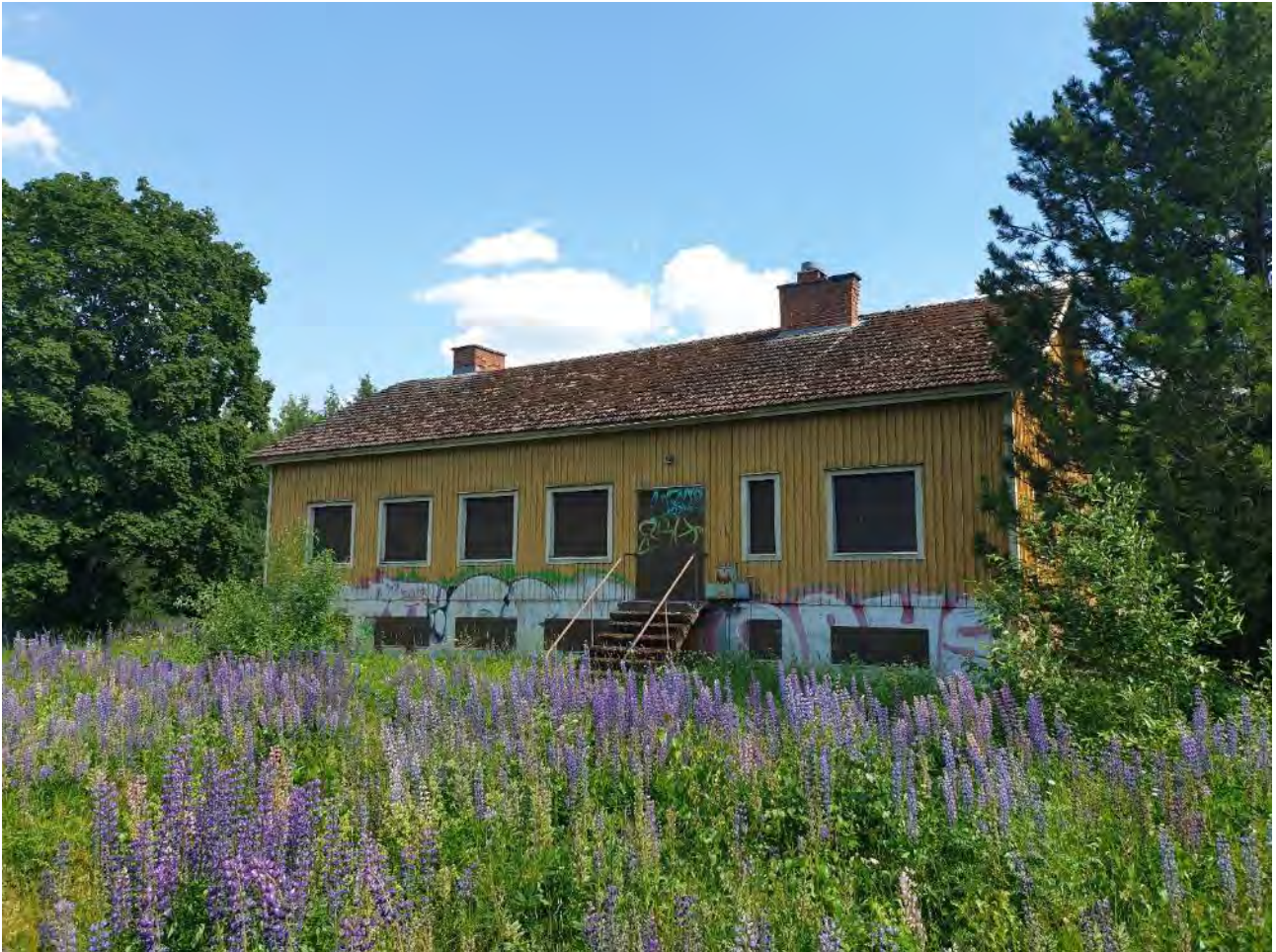
Kuva 3. Purkukuntoinen rakennus veturitallien pohjoispuolella.
