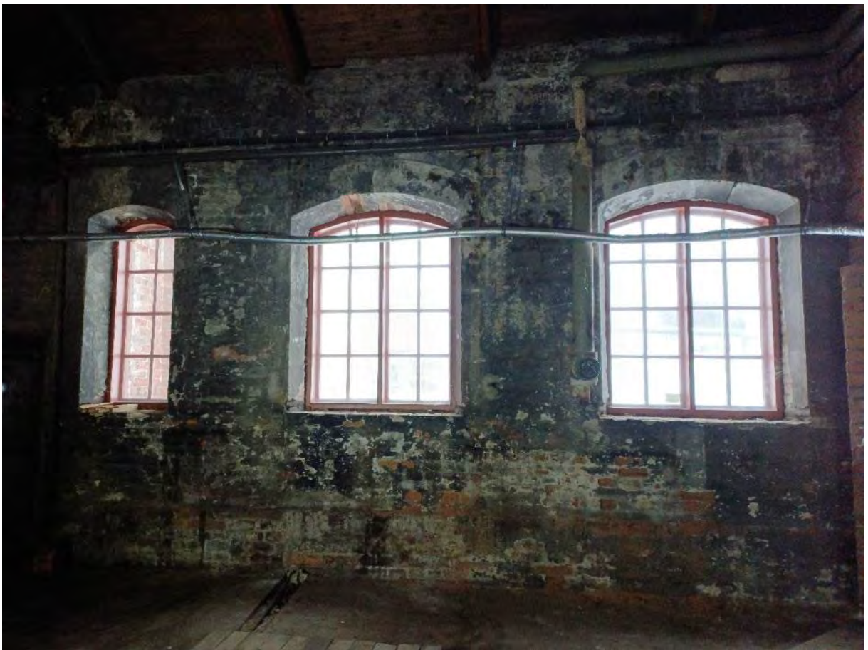
Kuva 80. Ikkunat on uusittu 1980-luvulla, mutta ikkuna-aukkojen muoto sekä ulkopuitteiden ruutujako on alkuperäinen. Valkoisiksi kalkatut seinät ovat tummuneet noesta.
