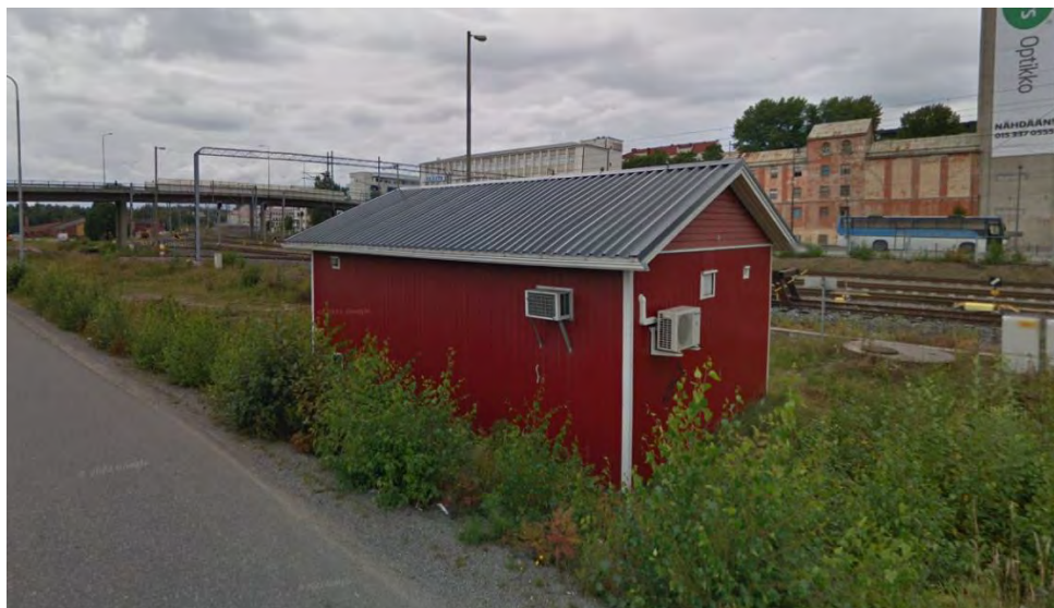
Kuva 19. Rautatiehen liittyvä sähkömuuntamo (Google 2011)
